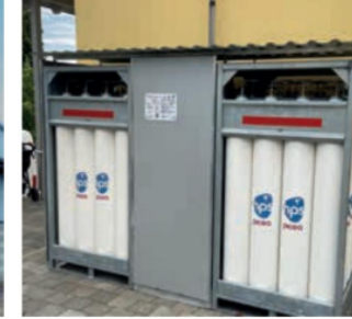
Wasserstoffspeicher, um in der sonnenärmeren Zeit aus Wasserstoff Strom und gleichzeitig Wärme zu produzieren.
